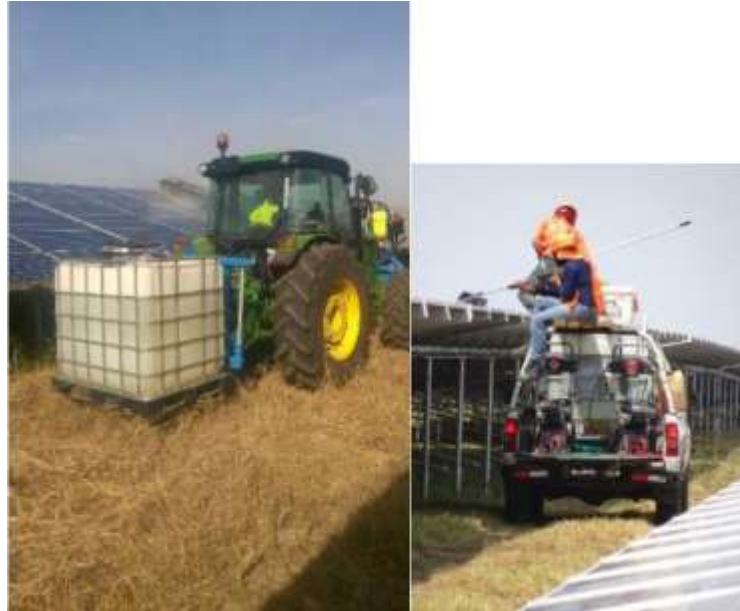
Figura 10. Exemplos de limpeza dos painéis solares
